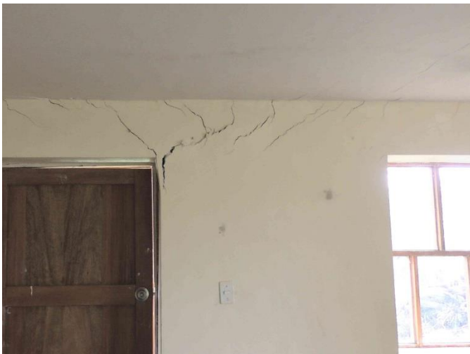
Zustand der Innenwände vor der Renovierung.
