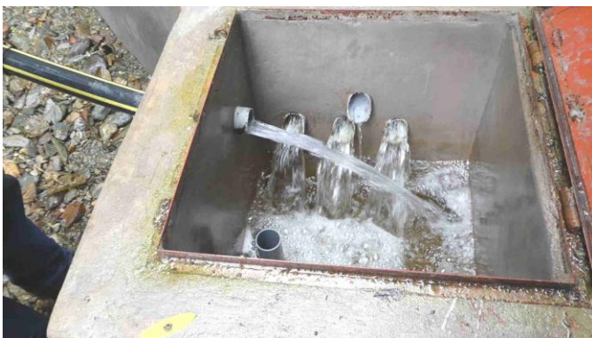
Wasserkammer aus der Nähe. Davon gibt es 3 weitere, bis das Wasser zum Haupttank in 3 km Entfernung fließt.
