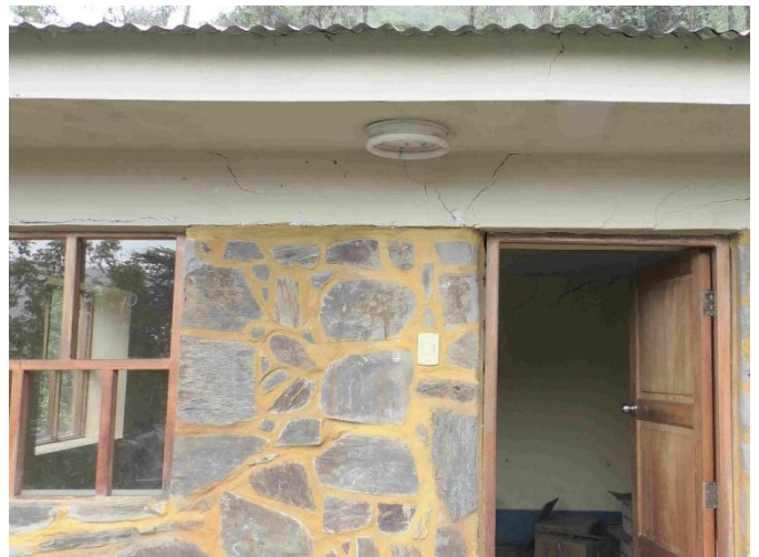
Die Aussenwände zeigten eine starke Rissbildung und wirkten sehr instabil.
